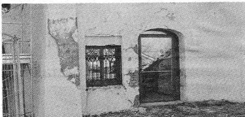
Un'immagine del degrado di alcune porzioni di Villa Draghi
